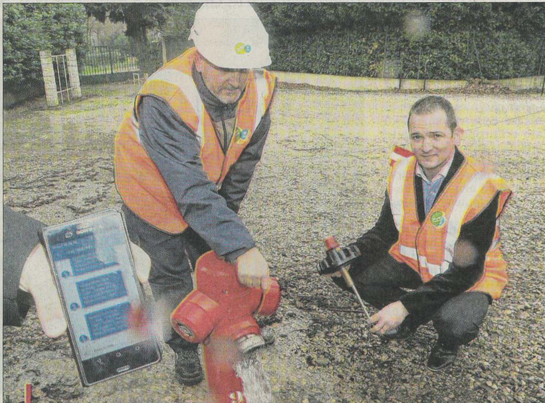
Dès qu'un poteau incendie est ouvert, le dispositif alerte immédiatement les services du Syndicat Rhône Ventoux par SMS et mail.
