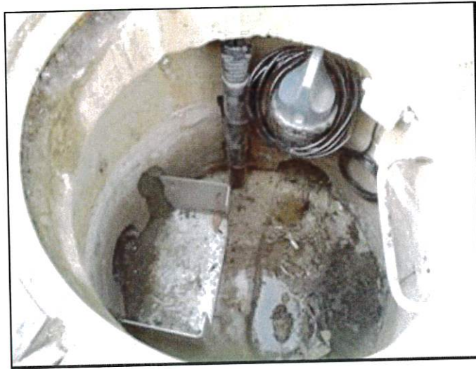
Figure 3 : Vue sur le déversoir d'orage (Source : SDA)
